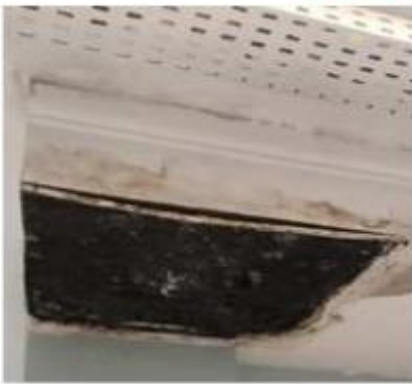
Parte do teto desabando
